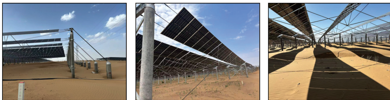
图4 柔性支架光伏电站实景
